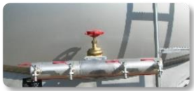
Barre arrière pour eau potable
